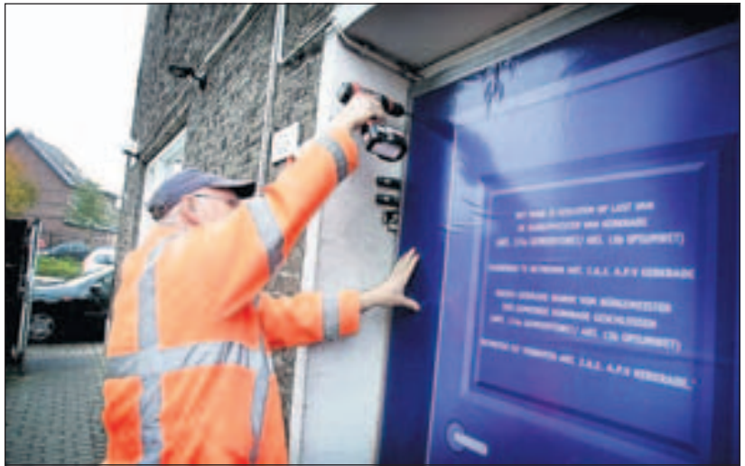
Een gemeentewerker spijkerde gisteren in aanwezigheid van de politie het drugspand aan de Niersprinkstraat dicht. foto Dries Linssen
